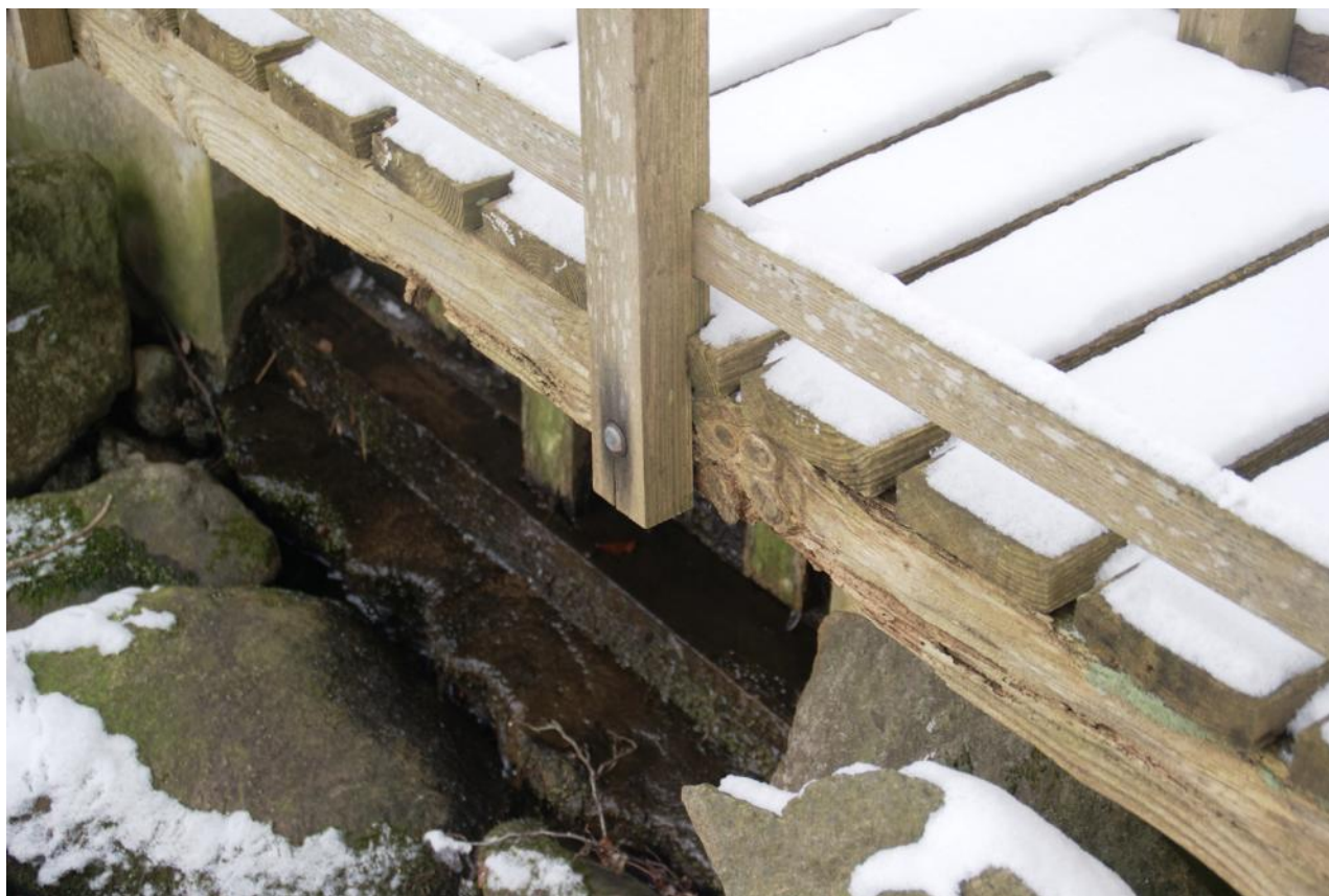
Det ses tydeligt, at råd og svamp har fået godt fat i gangbroen
